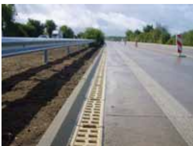
ACO Monoblock RD 200 V uz autoceļa A1 kā gareniskā drenāža
